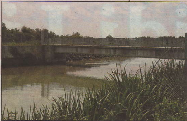
Un problème hydraulique sur le barrage anti sel est à l'origine de l'incident.
